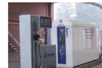
Tankanlage TCI (- 30.000 Liter)
