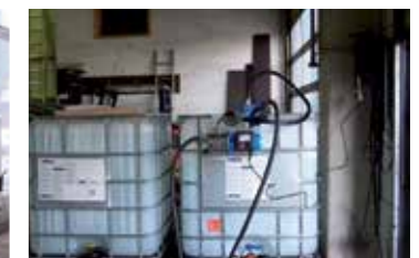
Tankanlage IBC (1.000 Liter)
